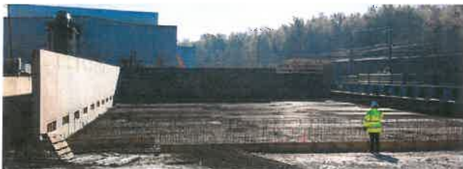
Début des travaux de remise en performance environnementale et économique de l'UVOM
